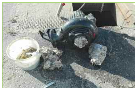
Verstopfung einer Pumpe in St. Peter November 2015
